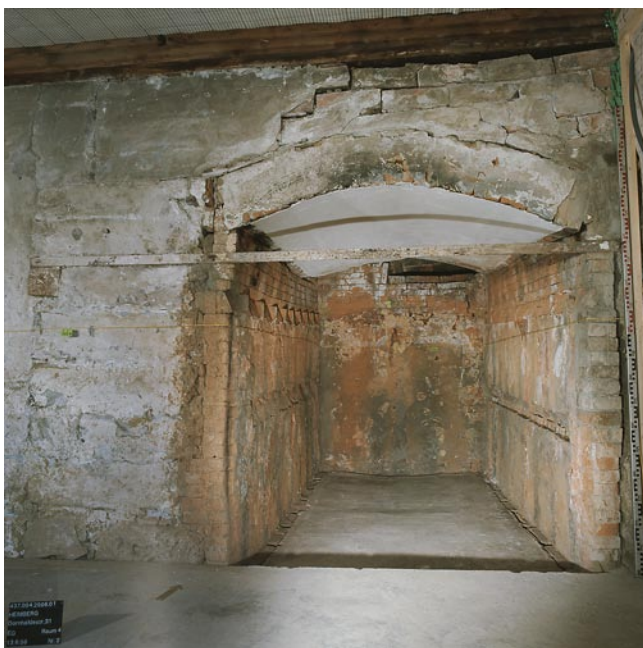
Abb. 14 Heimberg, Dornhaldestr. 31, 2006, Erdgeschoss. Ansicht des Brennofens. Erkennbar ist der aus Holzbalken und einem Flacheisen bestehende Ringanker sowie der Ansatz des fehlenden Zwischengewölbes.
