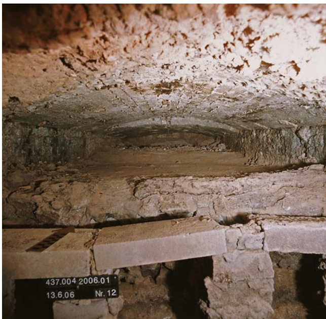
Abb. 17 Heimberg, Dornhaldestr. 31, 2006. Blick in den Feuerungsraum des Brennofens. Oben die flach gewölbte Lochtenne, vorne die Backsteinkonstruktion des Rostes.
